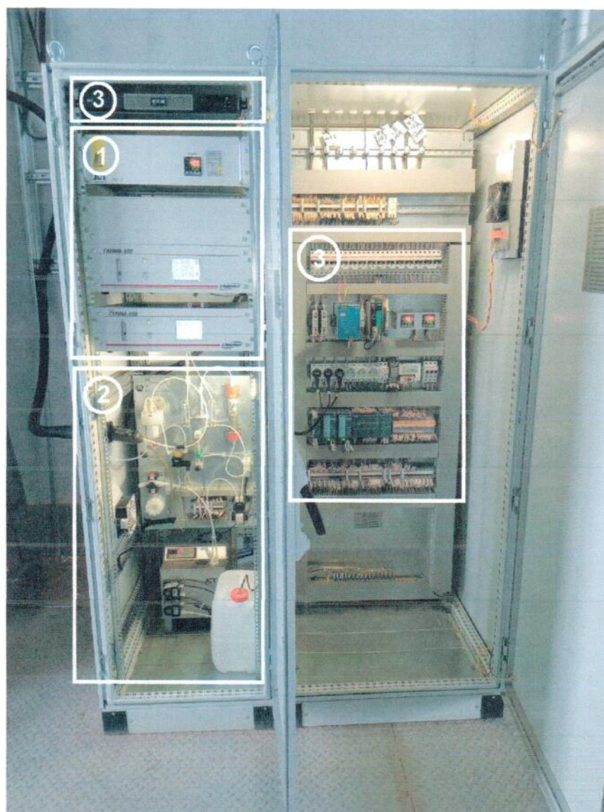
Рисунок 1.5 – Фотография шкафа АСКВ 1. Модуль аналитический №1; 2. Блок подготовки пробы; 3. Блок сбора, обработки и передачи данных №1.
