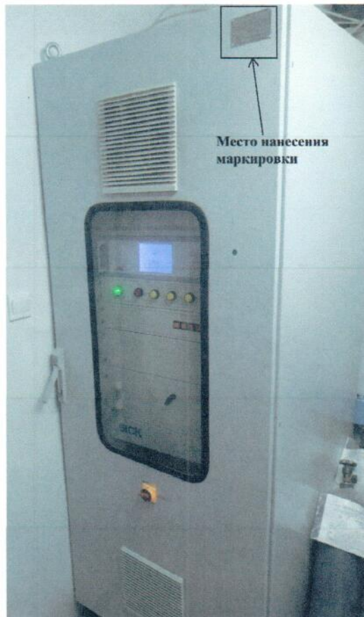
Рисунок 1.7 – Фотография шкафа газового анализа АСКВ с указанием места нанесения маркировки АСКВ
