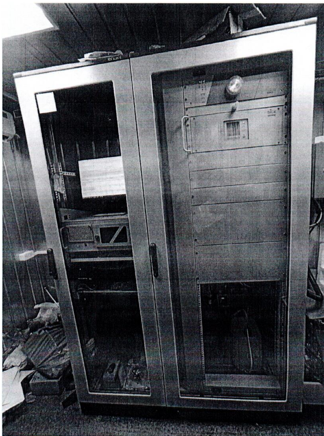
Рисунок 1.1 – Фотография общего вида. Система автоматизированного контроля и учета за выбросами загрязняющих веществ в атмосферный воздух от кольцевой нагревательной печи ТПЦ ОАО «БМЗ - управляющая компания холдинга «БМК» № СЭ.20133.АСК.УХЛ1
