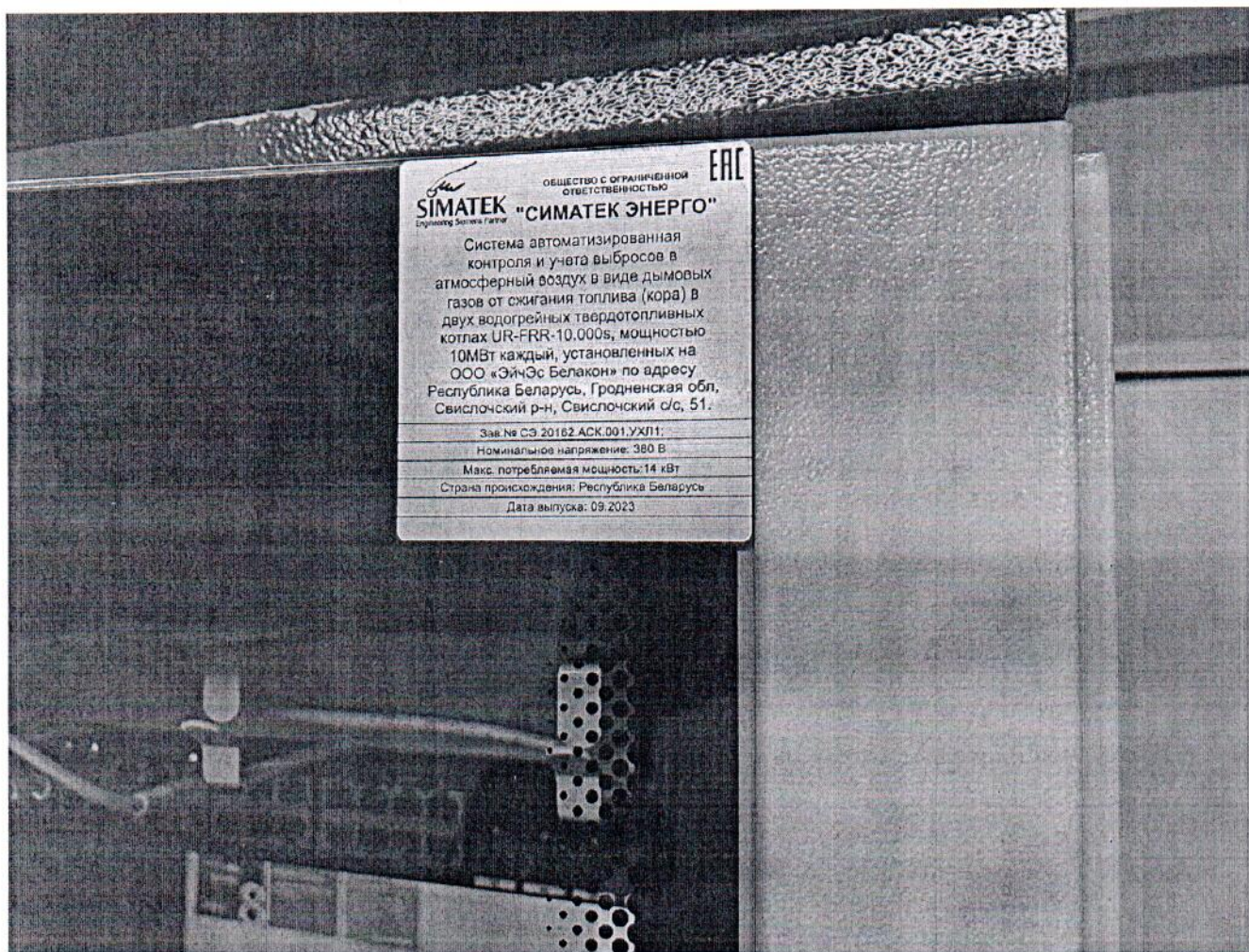
Рисунок 1.2 – Фотография маркировки. Система автоматизированная контроля и учета выбросов в атмосферный воздух в виде дымовых газов от сжигания топлива (кора) в двух водогрейных твердотопливных котлах UF-FRR-10.000s № СЭ.20162.АСК.001.УХЛ1
