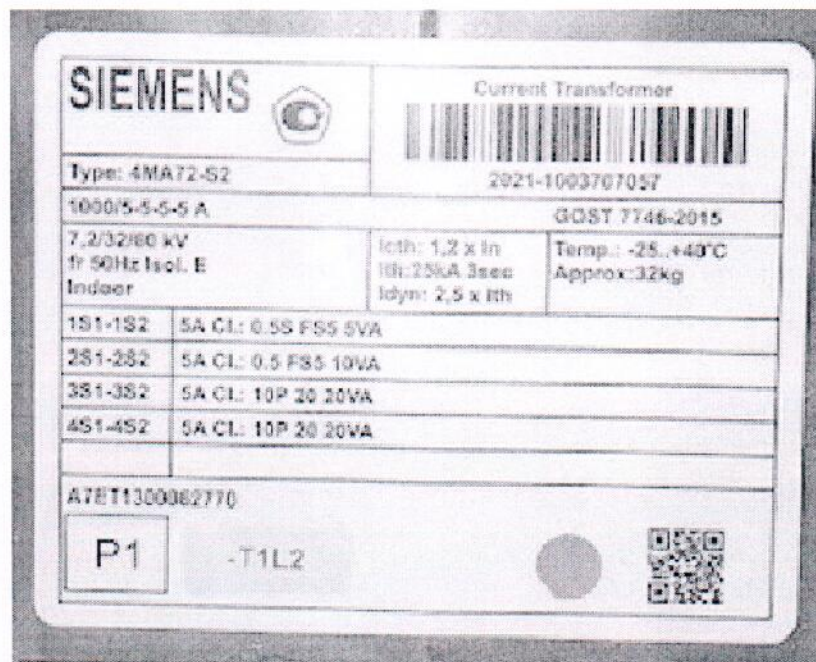
Рисунок 1.2 – Фотография маркировки трансформатора тока 4MA72-S2 АУС № 1003707057
