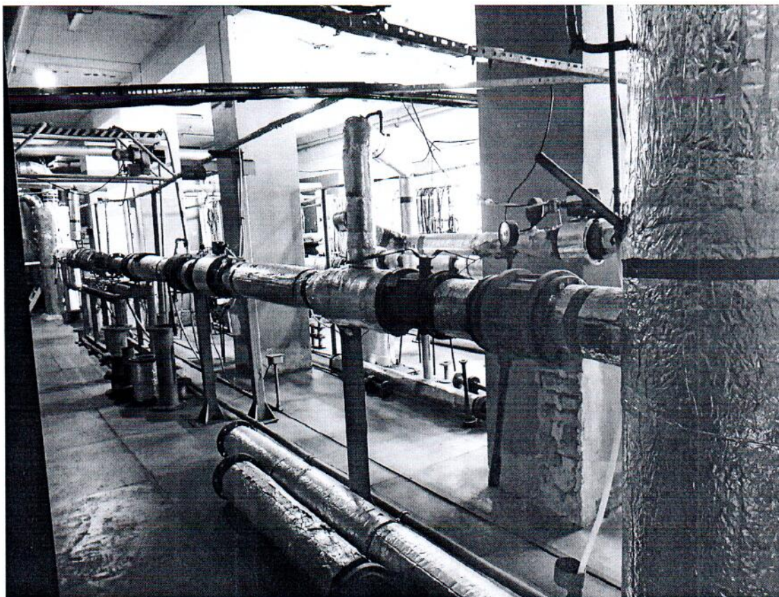
Рисунок 1.3 – Фотография общего вида ветки В установки поверочной горячеводной УГИП-400 МГ № 001
