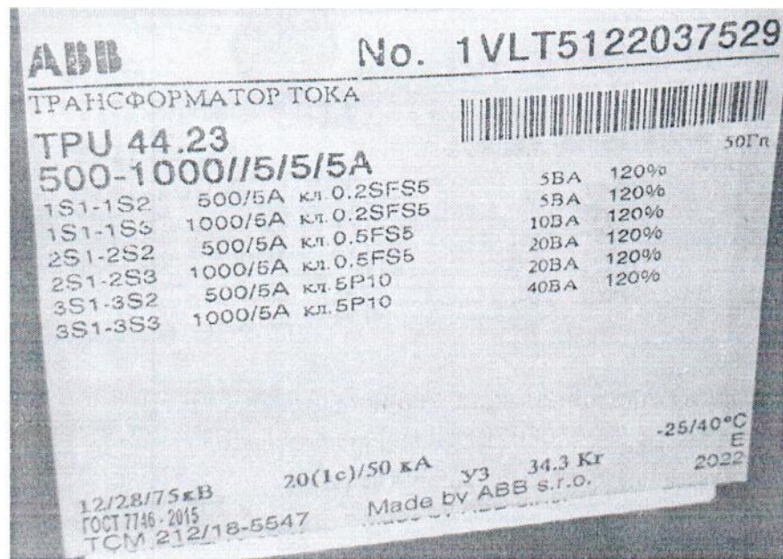
Рисунок 1.2 – Фотография маркировки трансформатора тока TPU 44.23 № 1VLT5122037529
