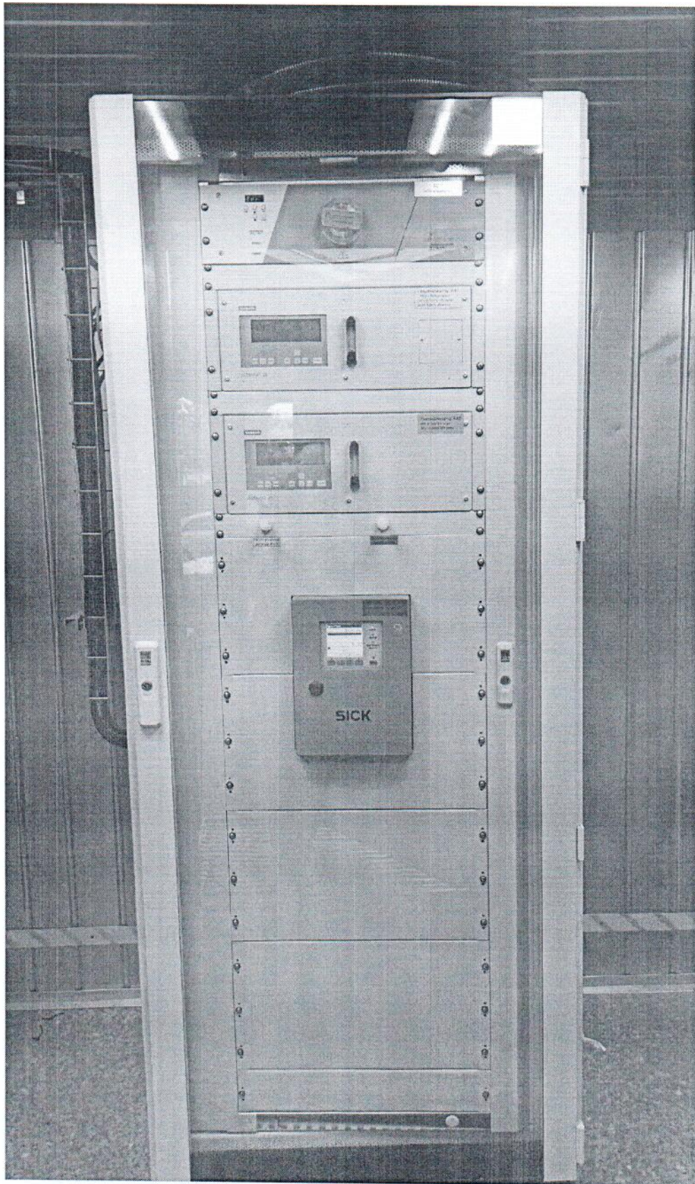
Рисунок 1 – Фотография общего вида шкафа АСК
