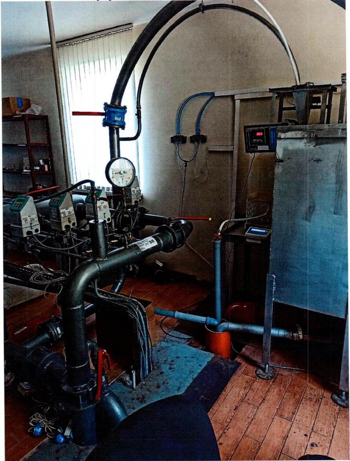
Рисунок 1.1 – Фотография общего вида проливной расходомерной установки М1205.00.00.007 № 01
