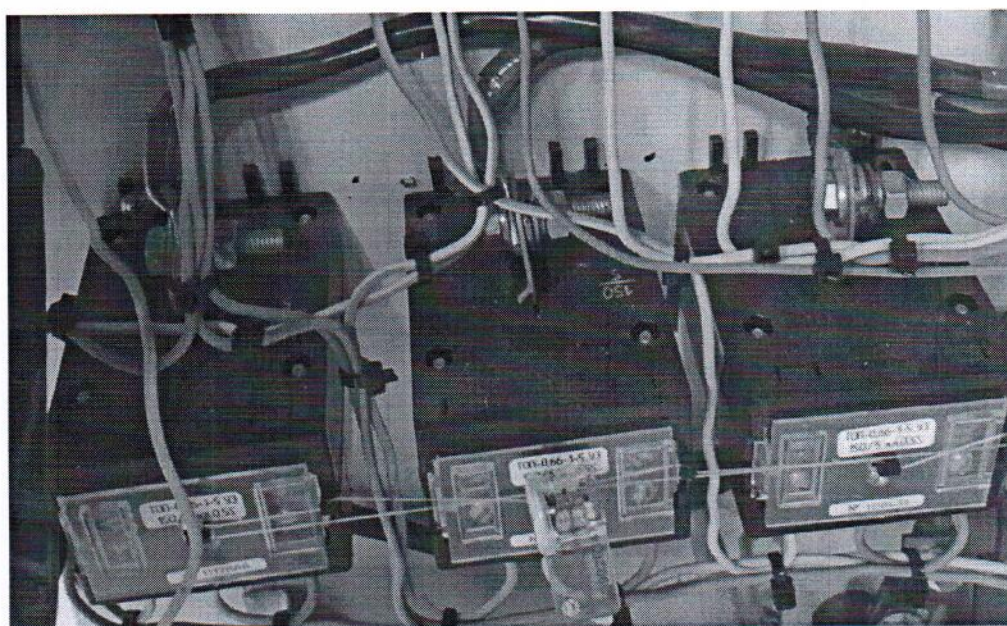
Рисунок 3 – Фотография компонентов АСКУЭ при применении трансформаторов тока ТОП-0,66
