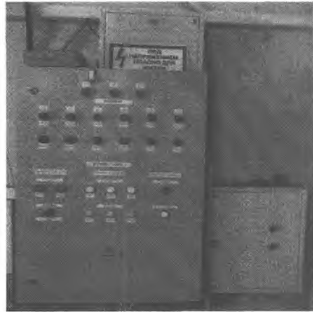
Рисунок 4. Шкаф управления насосами и автоматикой
